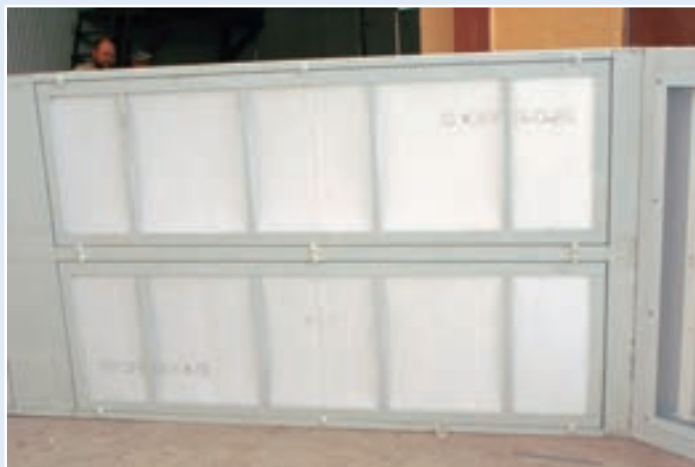
Потолочные фильтры крепятся в легко заменяемых кассетах.
